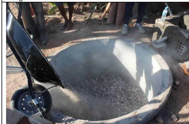
Figura 25: Camada de 10cm de brita do filtro biológico do Bioágua
