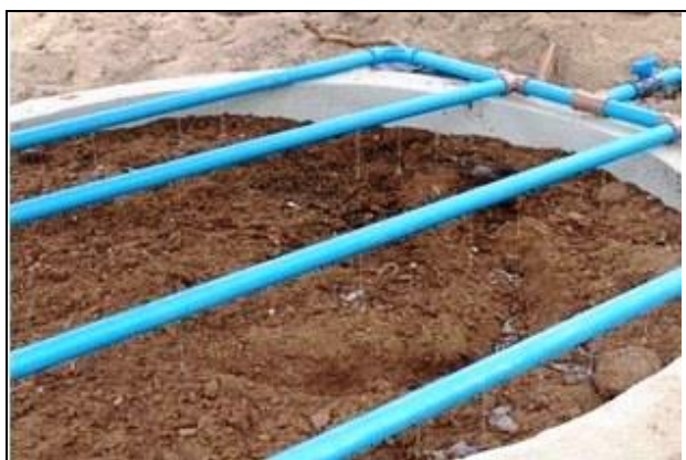
Figura 41: Tubulação de chegada com diferença de diâmetro do tubo de abastecimento do garfo no filtro biológico e registro instalado.
