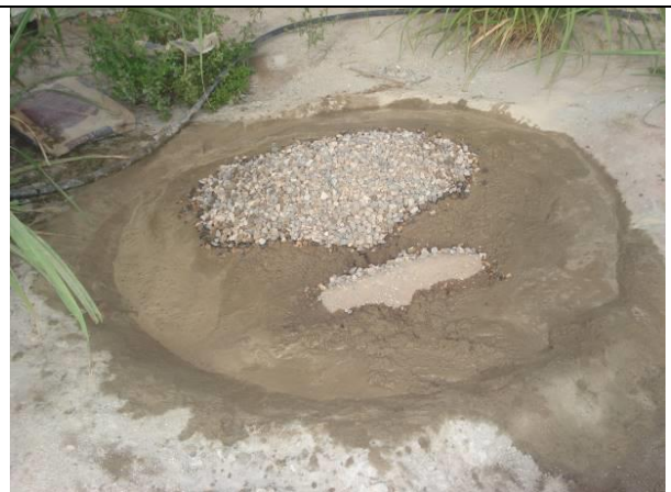
Figura 9: Adição de brita à mistura de cimento e areia. A água deve ser bem dosada e o local de execução da massa deve estar limpo.
