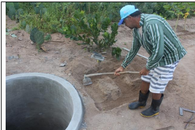
Figura 32: Escavação para construção do alicerce da casa de bombo junto ao tanque de reuso
