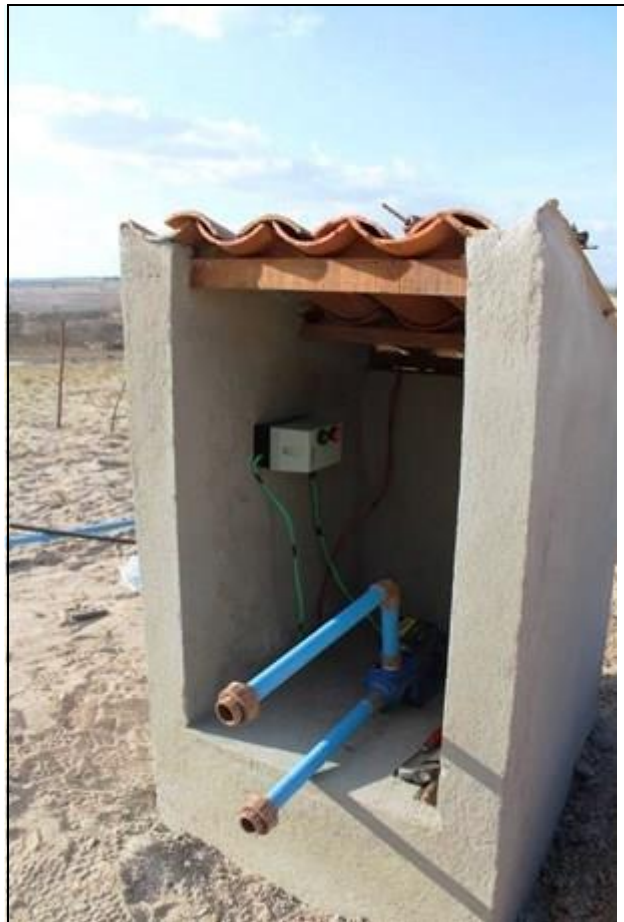
Figura 36: Instalação elétrica - Sistema de Bioágua. Dentro da casa da motobomba, detalhe da caixa de energia.
