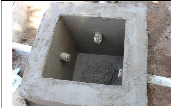
Figura 21: Caixa de gordura com tubulações conectadas. (esquerda) e ao lado a caixa de gordura rebocada (direita).
