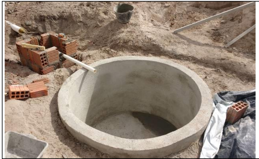
Figura 37: Detalhe de tubulação de chegada com diferença de diâmetro (tubo de 100) e tubo de abastecimento do garfo no filtro biológico (cano de 50).
